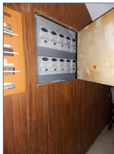
Contatori energia elettrica
