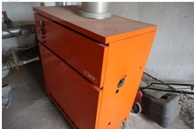
Caldaia condominiale nel locale c.t. piano terra
