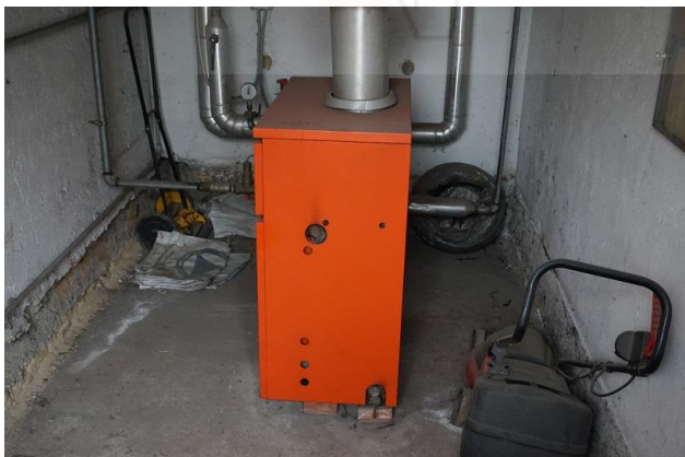
Caldaia condominiale nel locale c.t. piano terra
