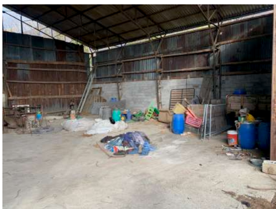
Deposito (parte abusiva de demolire).
