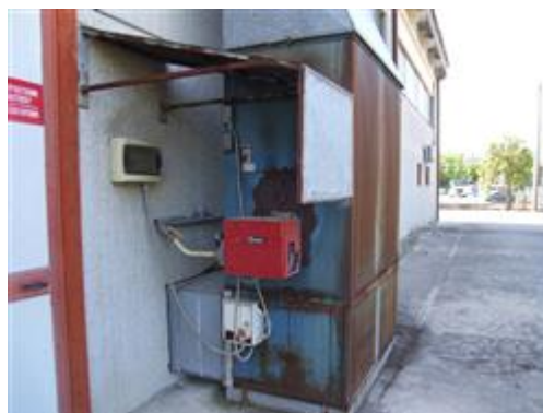
Posizione caldaia esterna
