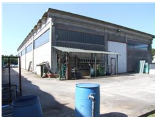
Tettoia con struttura precaria metallica leggera
