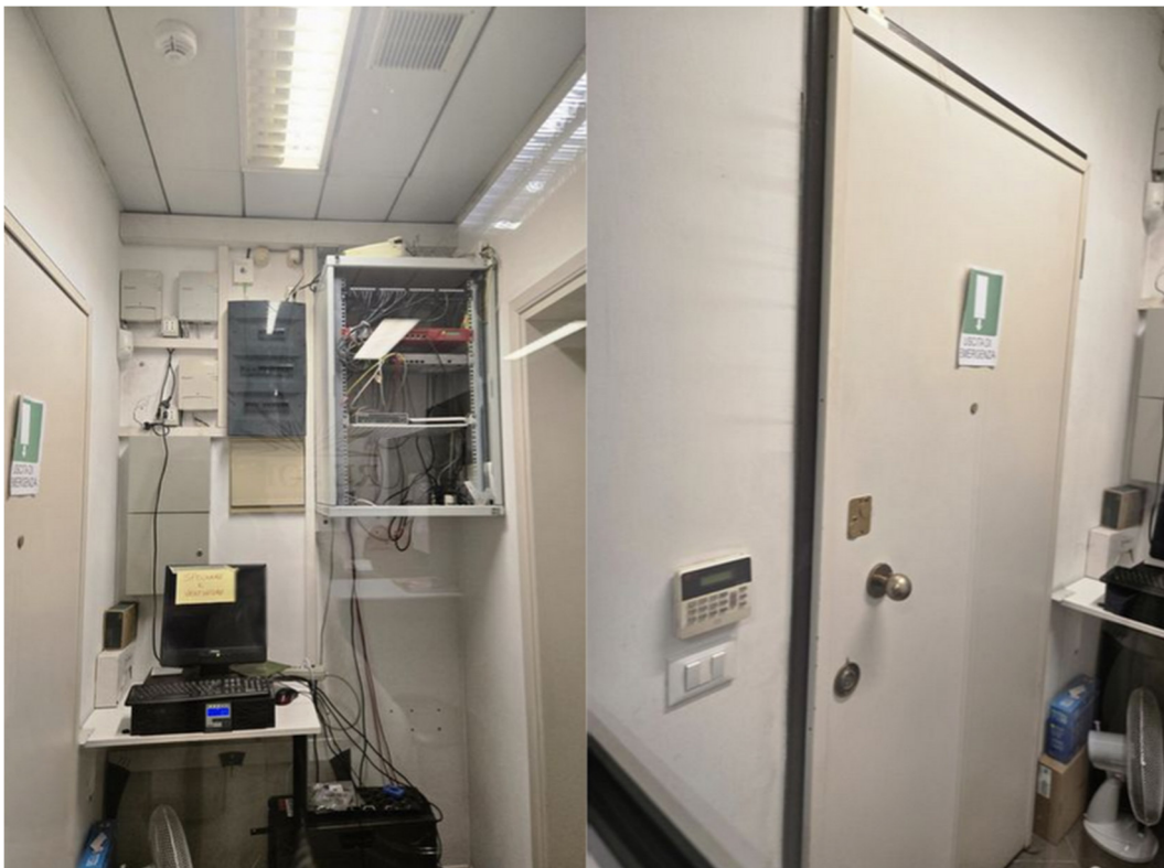
Fig.7-Ingresso; Porta blindata-pannello interno laccato di accesso all'ufficio;
