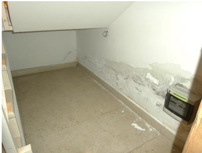
7. – Abitazione mappale 581 sub. 12: presenza di umidità di risalita nel sottoscala d'ingresso
