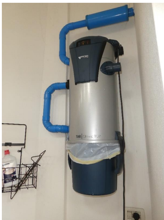
20. – Abitazione mappale 581 sub. 12: Interno Vano Tecnico nella terrazza
