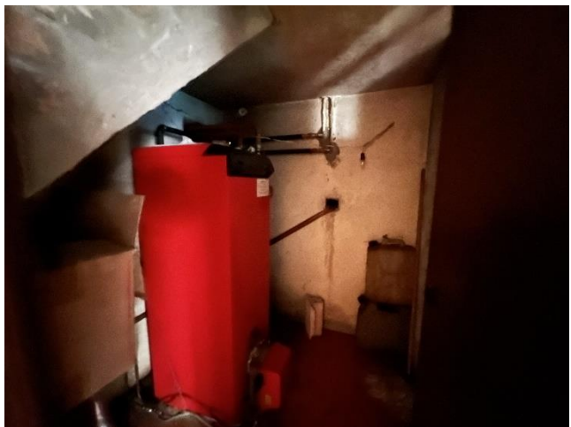
Vista della CT
