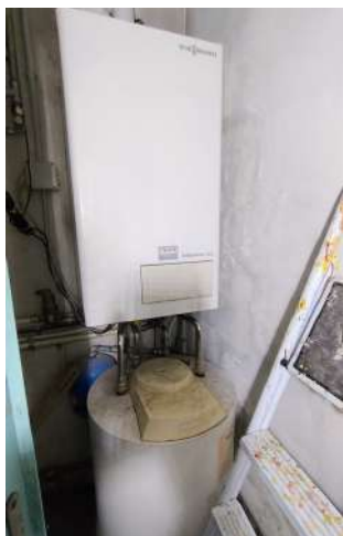
Caldaia centr. termica
