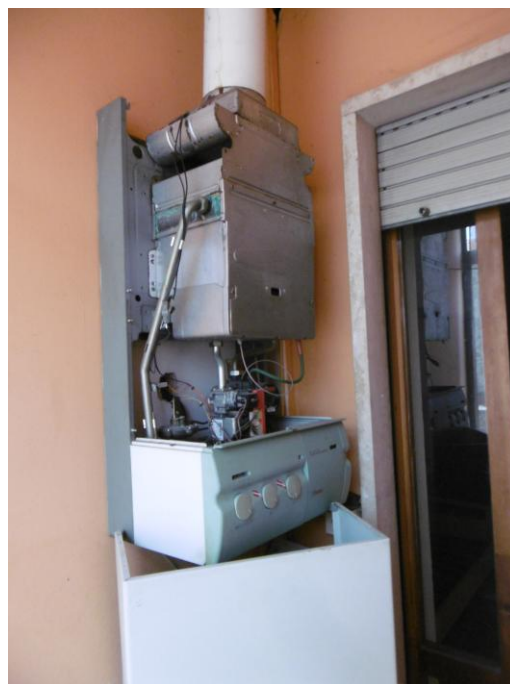
caldaia (posizionata nella loggia)
