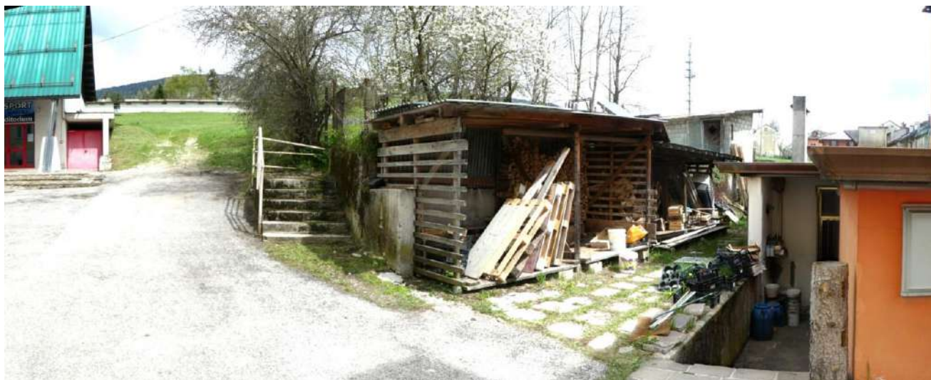
10. – Tettoie insistenti nel mappale 1430 da rimuovere – lato Sud/Ovest
