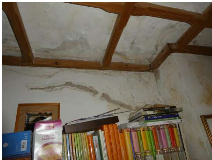
18. – Segni di infiltrazioni nel Locale Studio/Amministrazione
