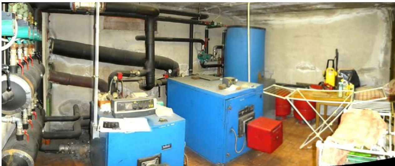
41. – locale Centrale Termica – piano Interrato
