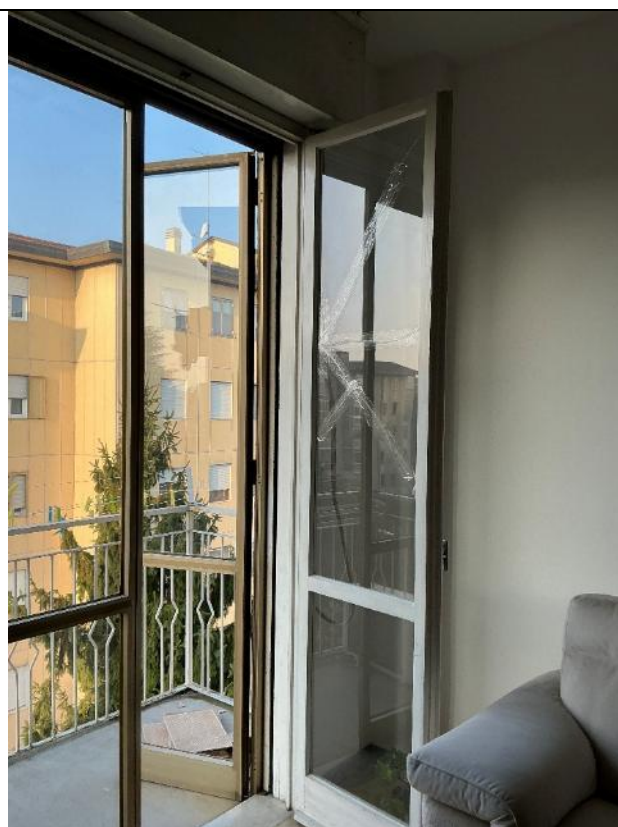
Foto 16: vetro rotto soggiorno
