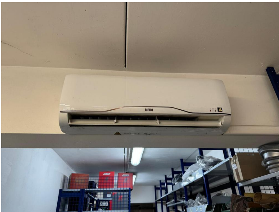
11. – Vista interna: negozio (imp. riscaldamento)
