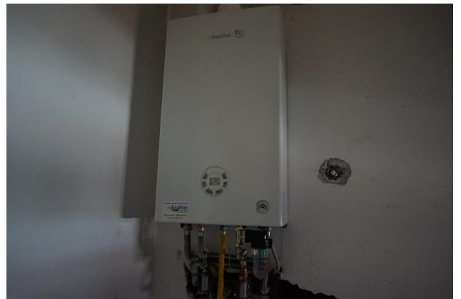
Piano terzo – Caldaia condivisa con altra unità
