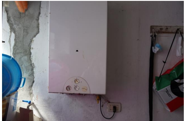
Piano primo – Caldaia all'interno del garage
