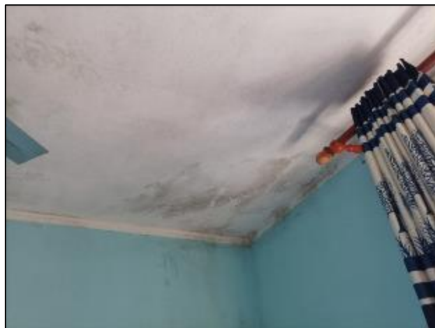
Segni di umidità sul soffitto di una camera
