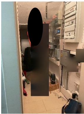
vano tecnico a servizio dell'imp. fotovoltaico
