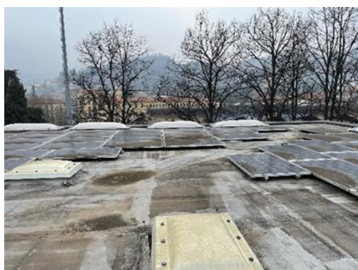
veduta pannelli impianto fotovoltaico
