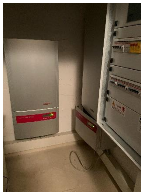
vano tecnico vista inverter
