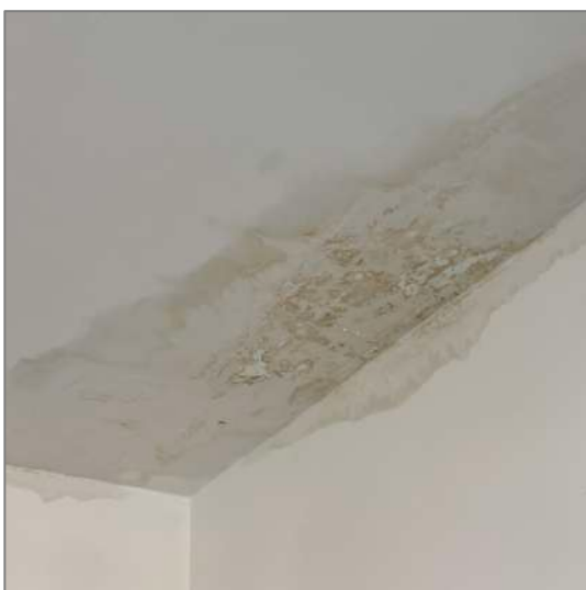
Infiltrazioni dal coperto
