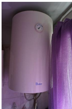
Piano primo – Bollitore bagno
