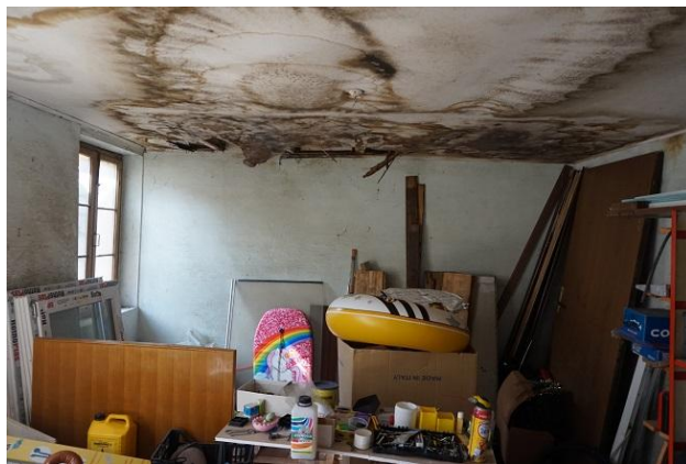
Piano Secondo – Camera nord e soffitto in parte crollato
