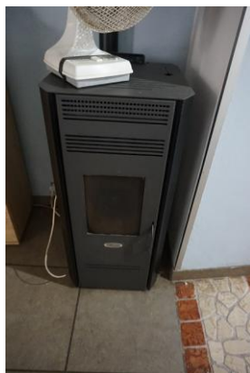
Piano Terra – Stufa a pellet in soggiorno
