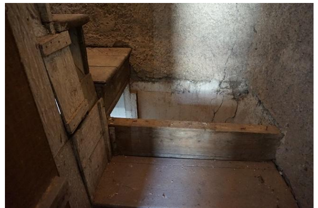
Piano Secondo – Scala nord priva di alcuni gradini
