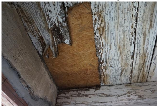
Piano Secondo – Particolare cattivo stato soffitto nord
