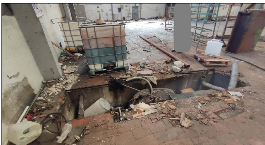
Vasche interrate piene di rifiuti speciali
