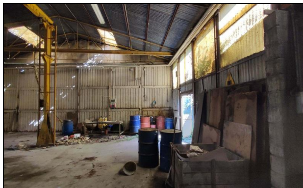
Vista interna immobile E – con rifiuti abbandonati
