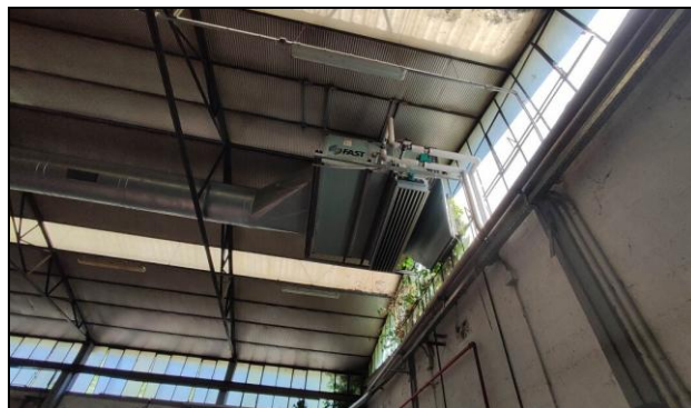
Impianti termici dismessi
