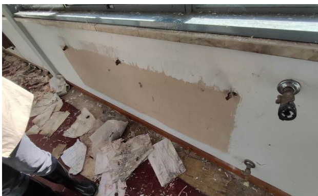
Uffici piano primo - ventilconvettori asportati
