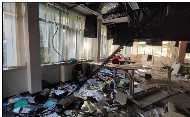
Uffici piano primo - controsoffitti asportati
