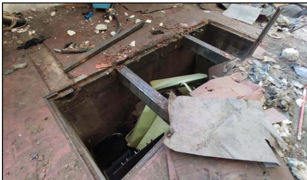
Vasche interrate piena di rifiuti speciali
