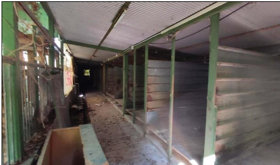
Canile lato est con strutture precarie
