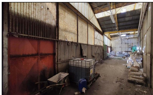
Vista interna immobile E – con rifiuti abbandonati
