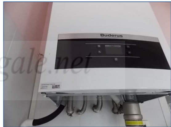
Caldaia (Buderus 2019) in antibagno
